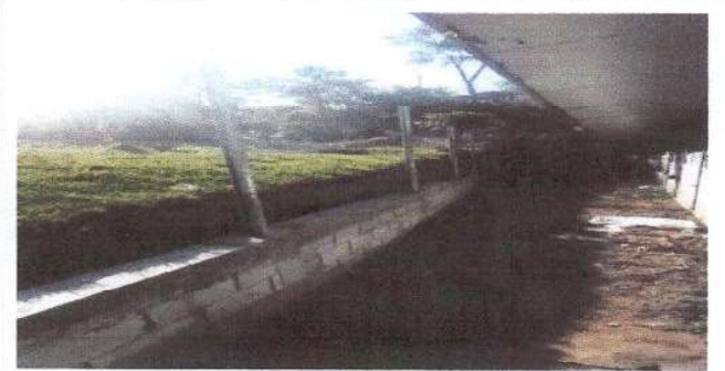
Foto 4: En la foto se observa una parte del muro perimetral a sustituir
